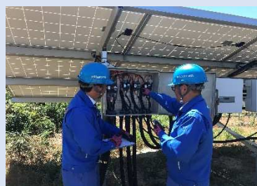
高圧テスターによる点検
